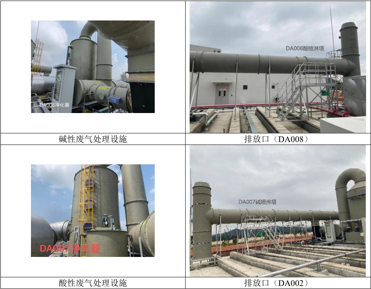
图4.3-3 项目废气处理设施、排放口、采样平台现场照片
