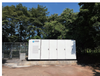
320kW/860kWh 广州市·南站某充电桩储能项目
