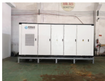
320kW/860kWh 广州市·某玻璃厂储能项目
