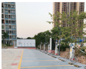
500kW/1075kWh 深圳市·某充电桩储能项目
