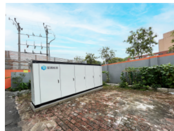
1000kW/2150kWh 东莞市·某医疗企业储能项目
