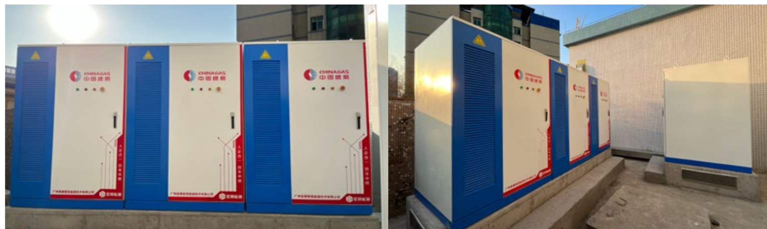
规模: 400kW/860kWh 项目: 东莞市·某电子制造企业储能项目
