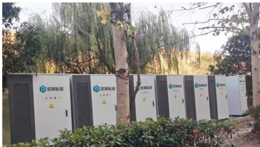
规模: 600kW/1290kWh 项目: 海宁市·某橡塑厂储能项目
