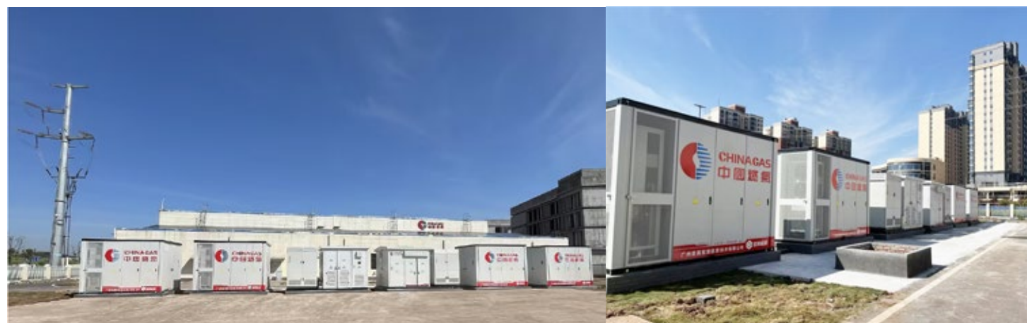
规模: 5MW/10MWh 项目: 湖南衡阳中国燃气某变电站储能项目
