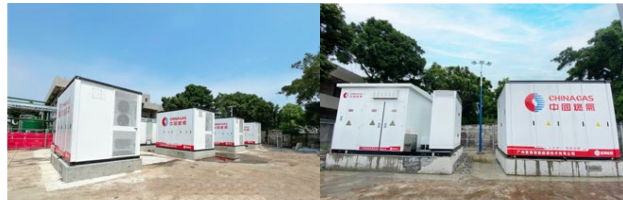
项目: 5MW/10MWh 规模: 广州市·某化工厂储能项目
