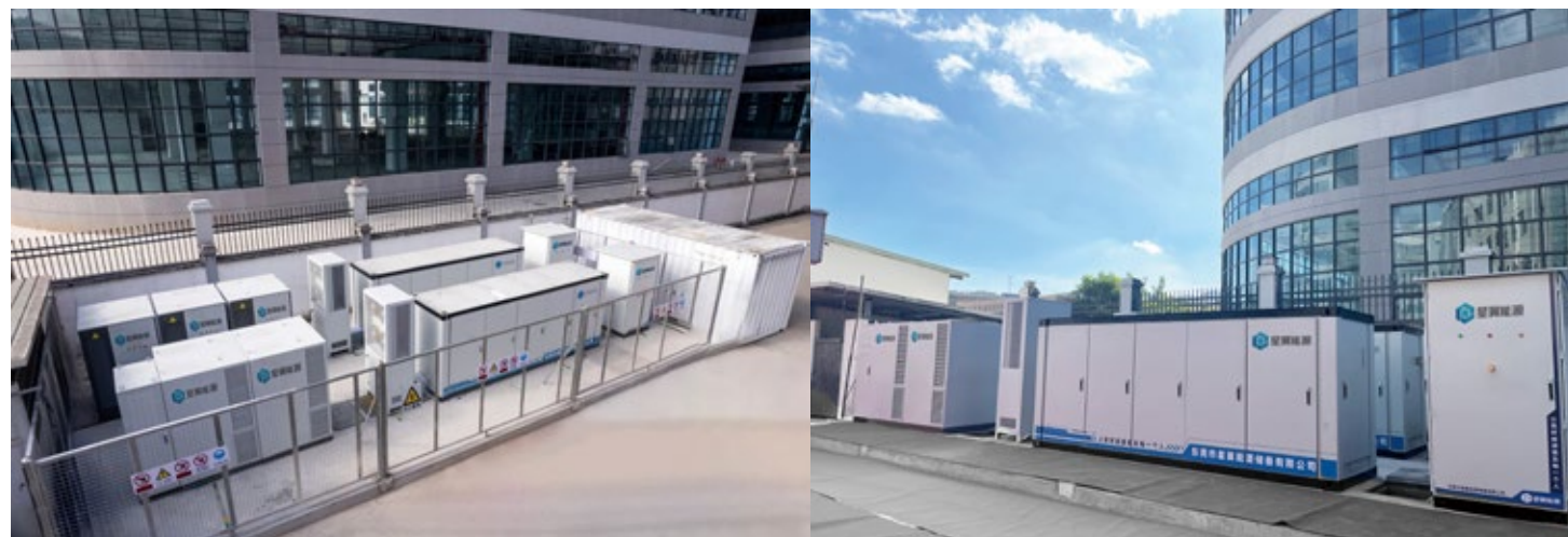
规模: 1500kW/3225kWh 项目: 东莞市·某电气维护有限公司储能项目
