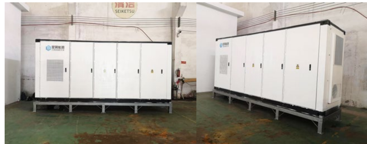
规模: 320kW/860kWh 项目: 广州市·某玻璃厂储能项目
