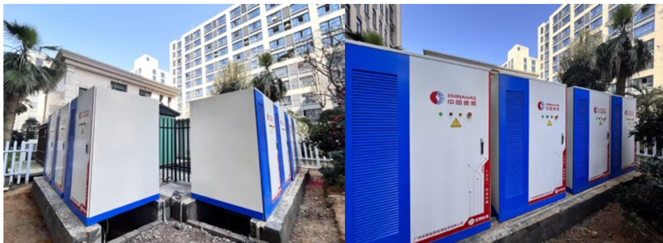
规模: 700kW/1505kWh 项目: 浙江金华某智创园储能项目
