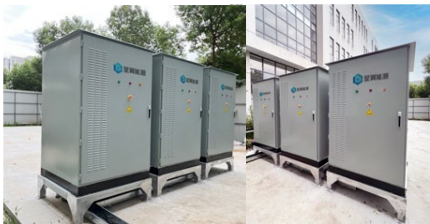
规模: 300kW/645kWh 项目: 上海市·某能源技术公司储能项目
