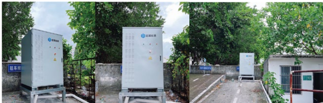
规模: 100kW/215kWh 项目: 广州市·某能源服务有限公司储能项目
