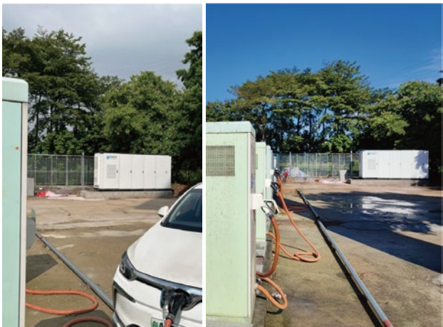
规模: 320kW/860kWh 项目: 广州市·南站某充电桩储能项目
