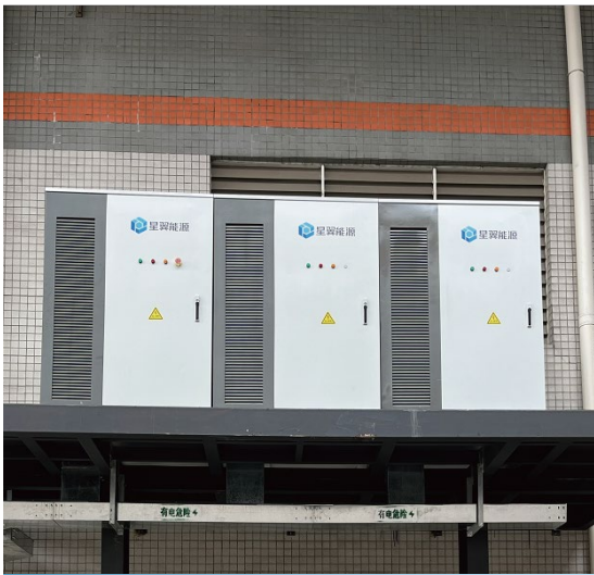
规模:300kW/645kWh 项目：佛山市·某电子有限公司储能项目
