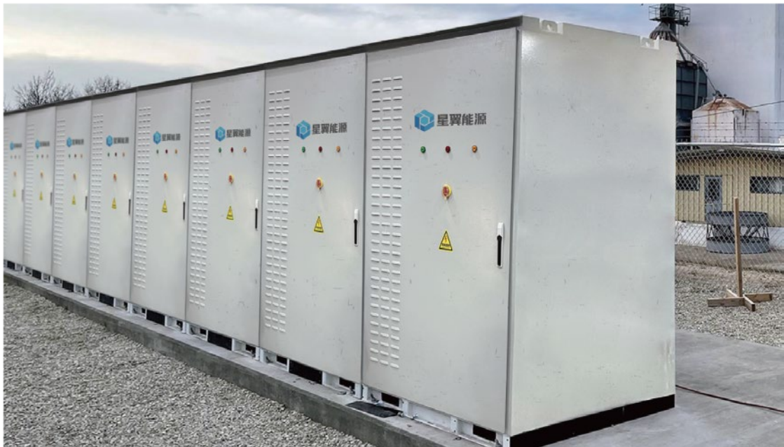
规模：800kW/1720kWh 项目：惠州市·某电子公司储能项目
