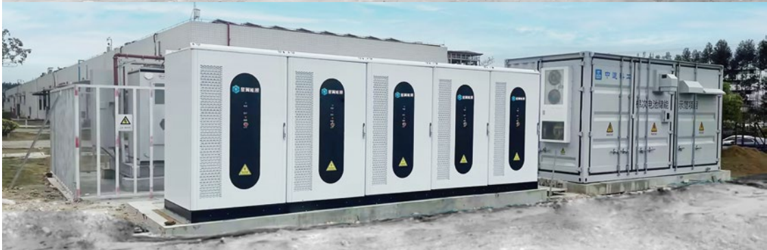
规模: 500kW /1075kWh 项目:广东省惠州市·某建筑企业储能项目
