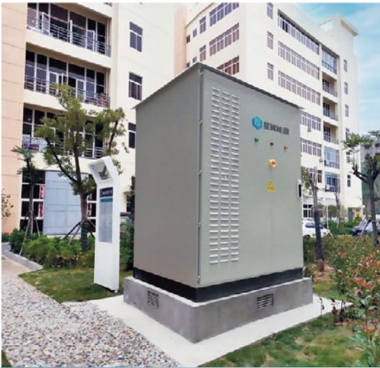
规模：100kW/215kWh 项目：佛山市·某创意园储能项目
