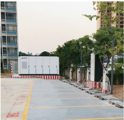
规模: 500kW/1075kWh 项目: 深圳市·某充电桩储能项目
