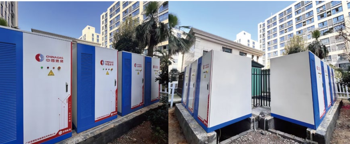
规模: 700KW/1505KWh 项目: 浙江金华某智创园储能项目
