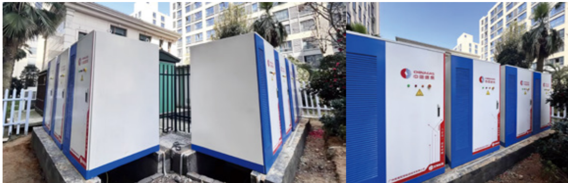
规模：700kW/1505kWh 项目：浙江省金华市·某智创园储能项目
