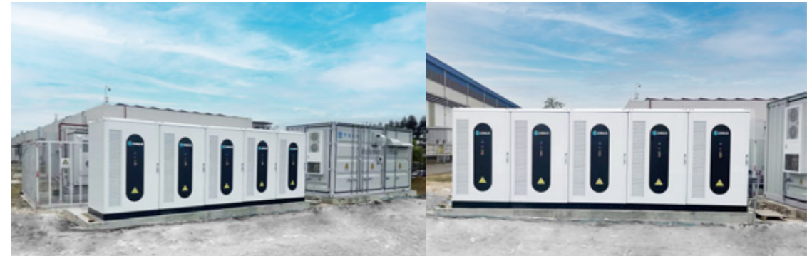
规模：500kW /1075kWh 项目：广东省惠州市·某建筑企业储能项目
