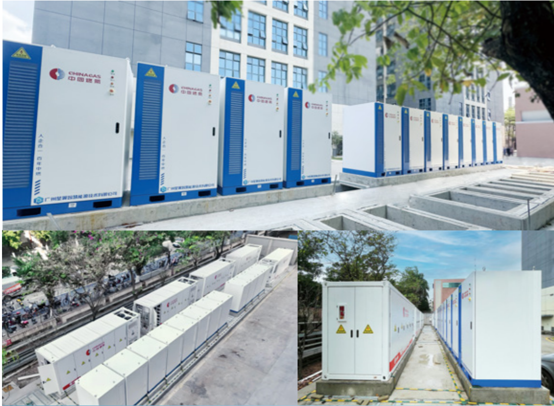
规模：4.1MW/8.815MWh 项目：广东省东莞市·某光电科技公司储能项目
