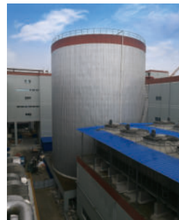
大型钢制保温蓄冷水槽
