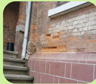
墙体严重风化
