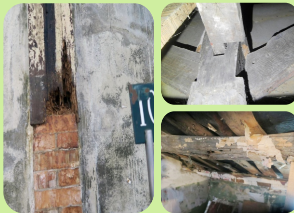
木构件断裂、节点松脱、腐蚀等
