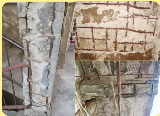
钢筋混凝土柱、梁、板严重露筋锈蚀
