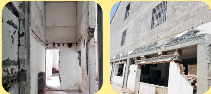
擅自变动建筑主体和承重结构
