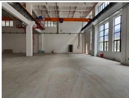
设备拟安装使用区域 1
