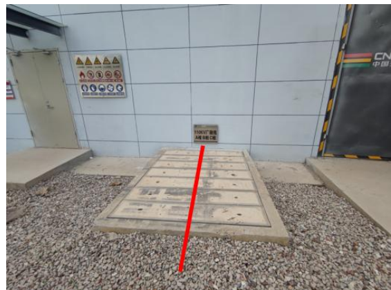
升压站出线处
