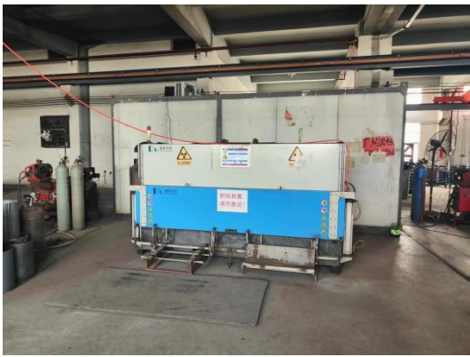
二楼拟使用 DU201 型 X 射线数字成像检测系统现状
