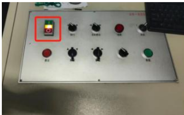
图 10-13 DU201 型 X 射线数字成像检测系统急停装置现状图
