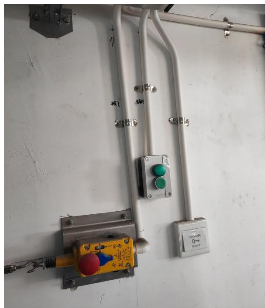
辐照室入口拉线开关和紧急开门开关
