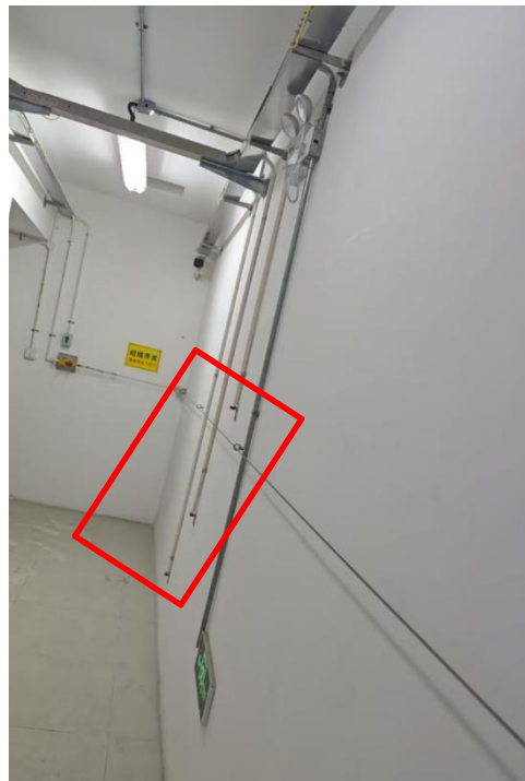
主机室内光电装置
