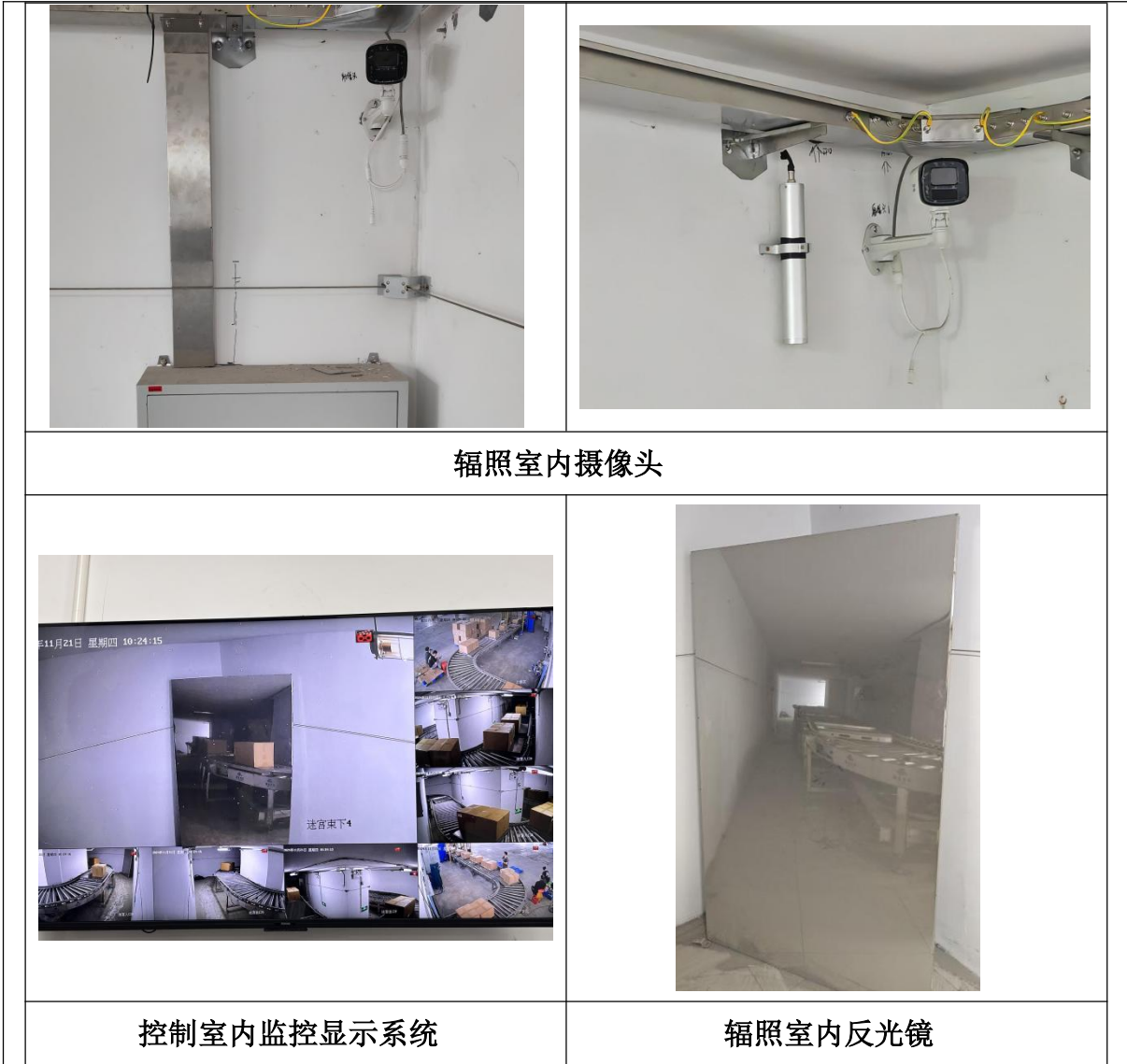
图 3-13 监控设施实物图
