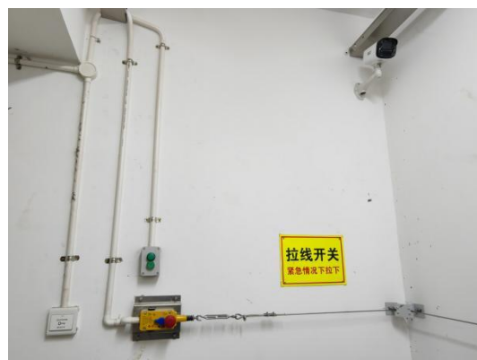
主机室拉线开关和紧急开门开关
