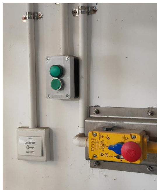
辐照室出口拉线开关和紧急开门开关
