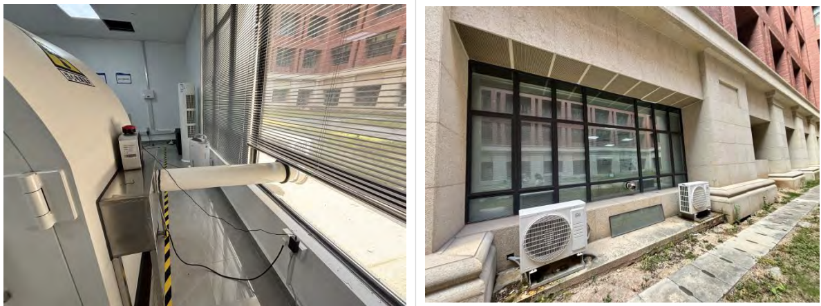
图 3-9 岩芯 CT 扫描仪排风装置实物图
