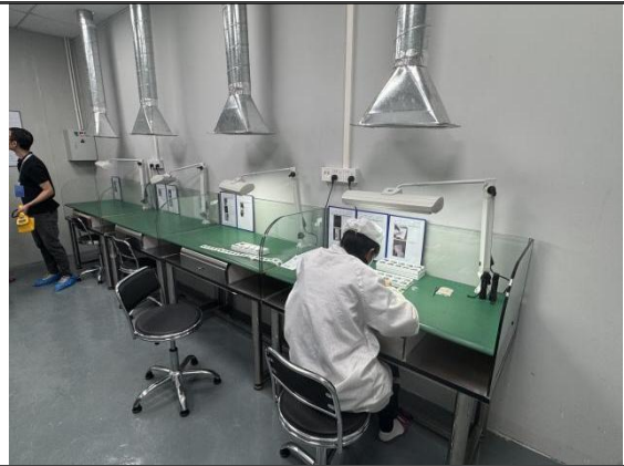
氟气管安装车间内工位
