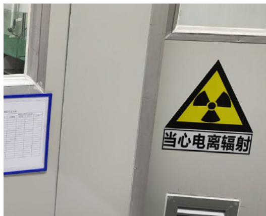
氚气管安装场所电离辐射标识
