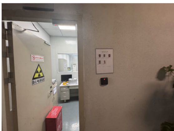
缓冲间电离辐射标识
