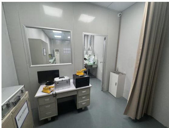
氟气管安装车间西南侧缓冲间
