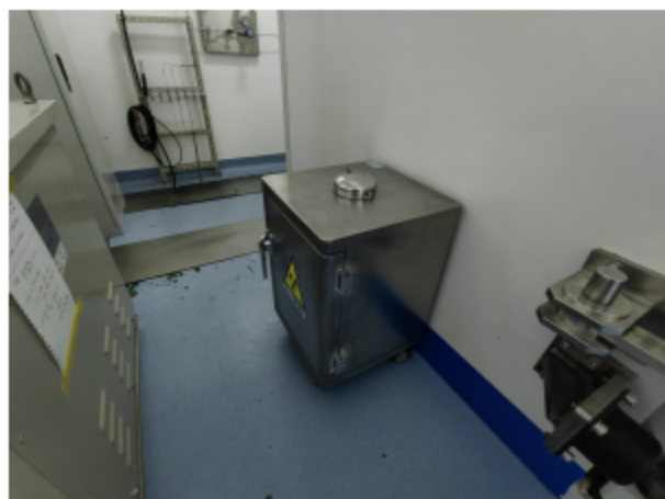
药物制备场所加速器靶废物铅防护箱
