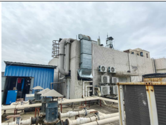
图 3-12 排风系统排风口实物图
