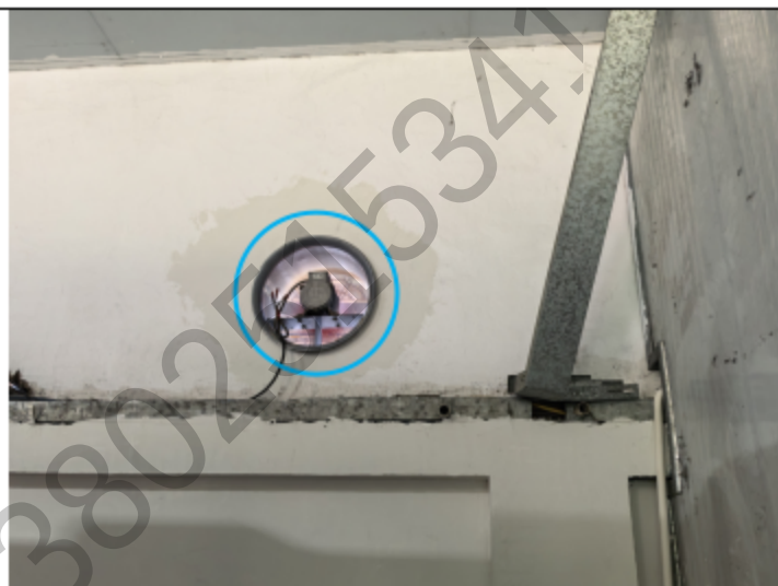
图 3-13 探伤机检测间机械排风扇（蓝圈为机械排风扇）
