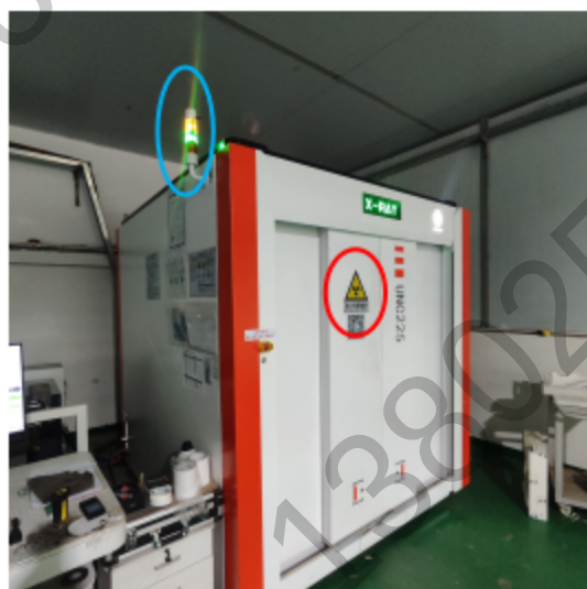
图 3-6 射线装置外部工作状态指示灯和电离辐射警示标志 (蓝圈为工作状态指示灯，红圈为电离辐射警示标志)
