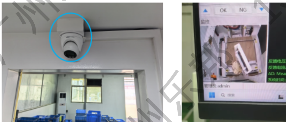
图 3-11 射线装置内部摄像头和外部视频图像（蓝圈为摄像头）
