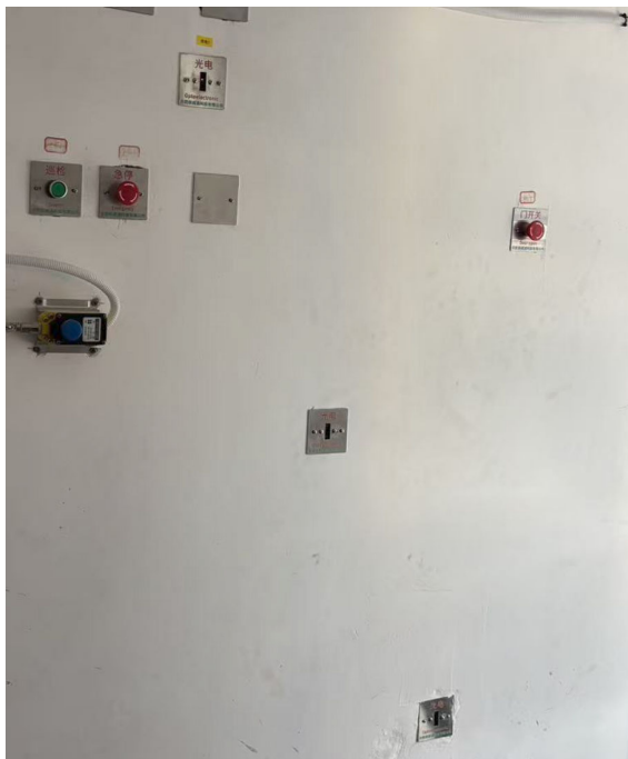
辐照室光电装置
