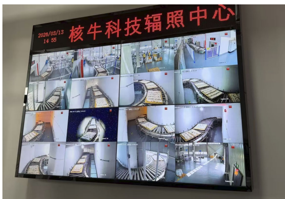
图3-16 加速器机房监控设施
