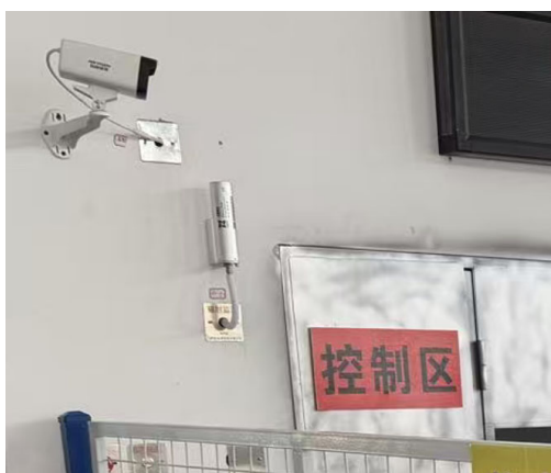
辐照室外剂量探头
