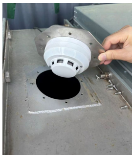
图3-14 加速器机房通风管道内烟雾报警
