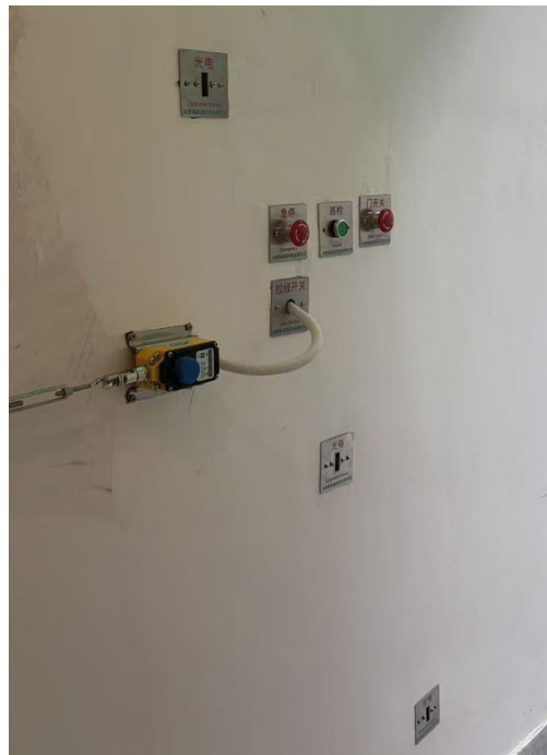
主机室光电装置
