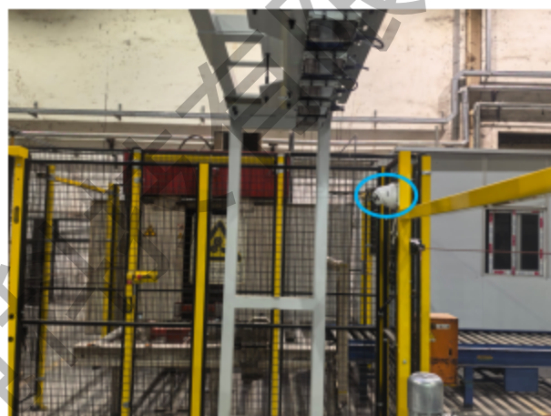
屏蔽铅房外的摄像头实物图
