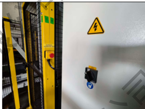
屏蔽铅房外的急停按钮实物图
