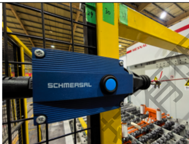
屏蔽铅房外的拉线开关实物图
