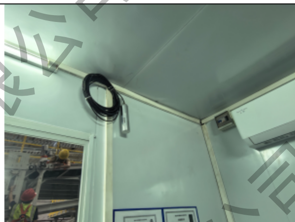
在线监测系统的控制室探头实物图
