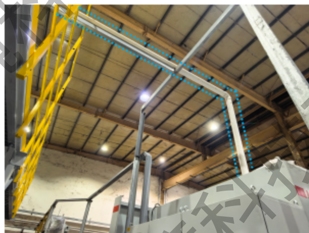
专用排风管实物图
