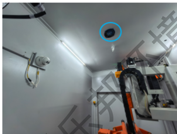
屏蔽铅房内的排风口实物图
