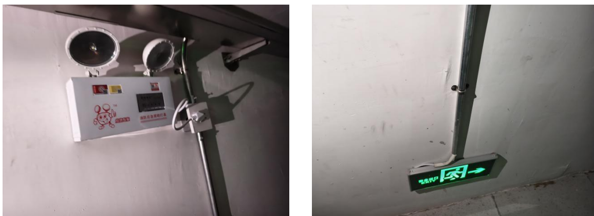
图 3-23 应急照明和紧急疏散标识
