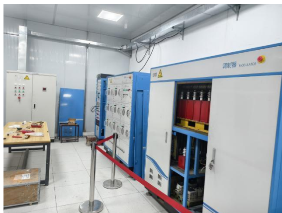
主机室东南侧设备室
