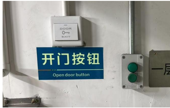
一层辐照室开门按钮
