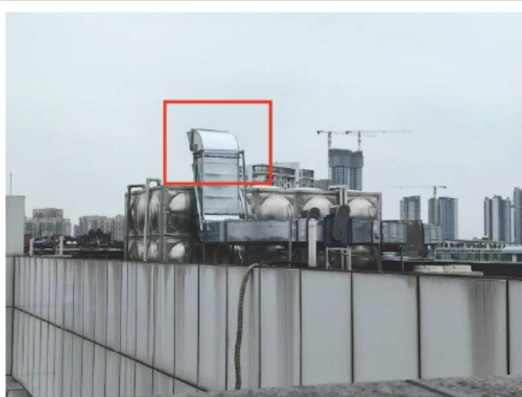
核医学科排风口
